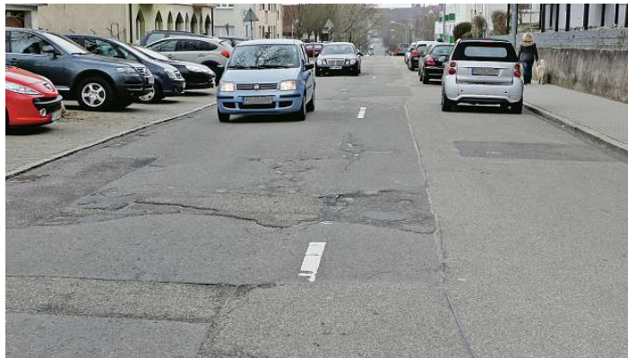
Am schlimmsten sind die Fahrbahnschäden im östlichen Bereich der Redtenbacherstraße. Hier ist Tempo 30 oft schon zu schnell. FOTOS: KETTERL
