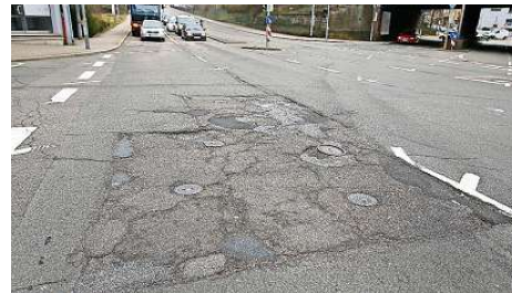
Immer wieder geflickt: Der Bereich um die Hydranten im Kreuzungsbereich bei der Brötzinger Eisenbahnunterführung.
