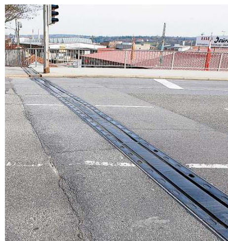
Vor Jahren schon einmal ausgebessert. Der Bereich am Widerlager der Nordstadtbrücke. Die Schwelle wirkt beim Befahren wie ein Brett.
